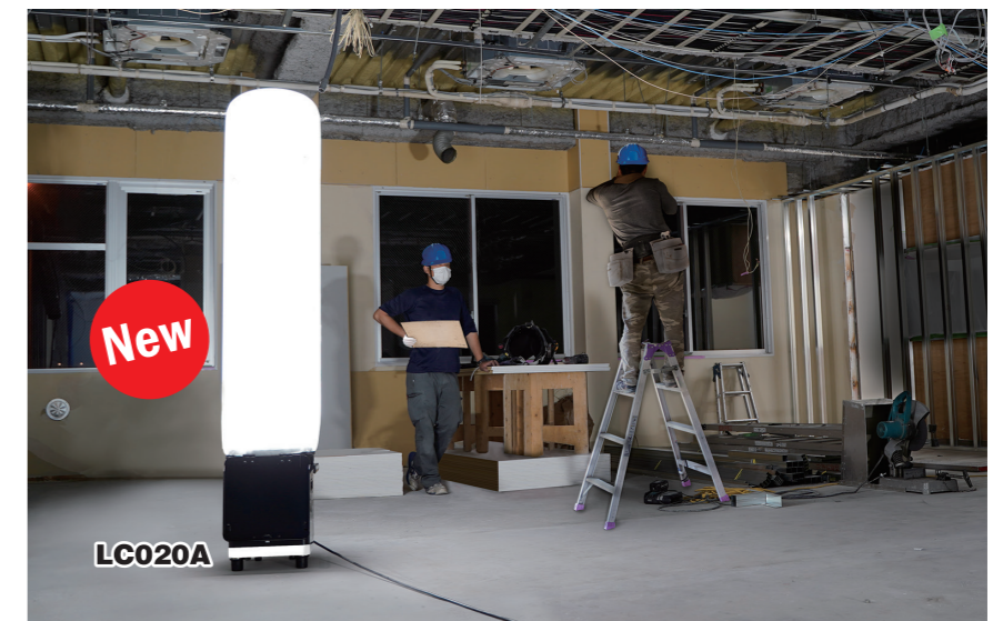
現場の 照明 として!
