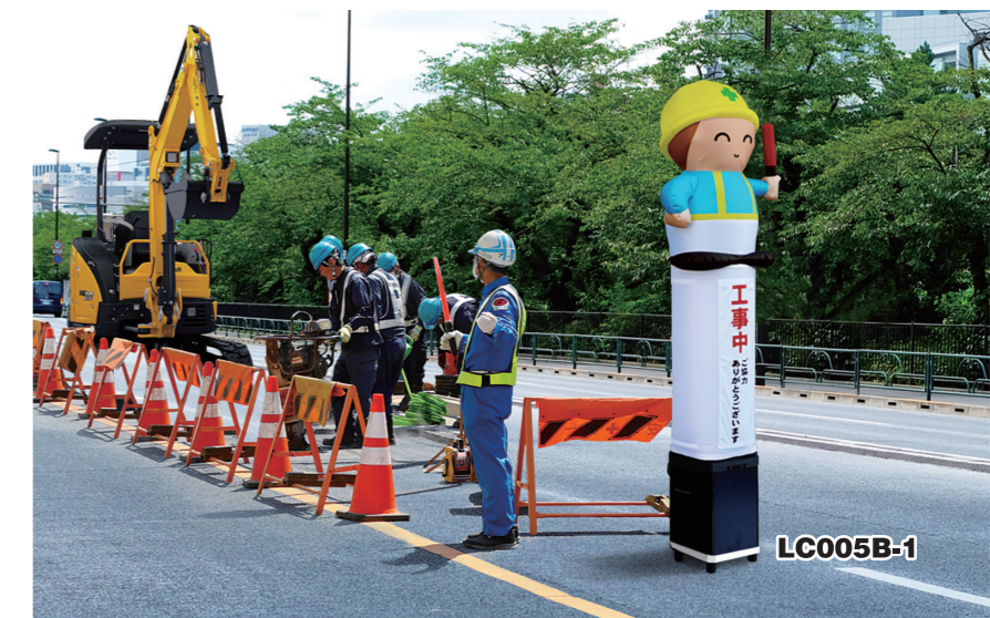
現場の 注意喚起 として!
